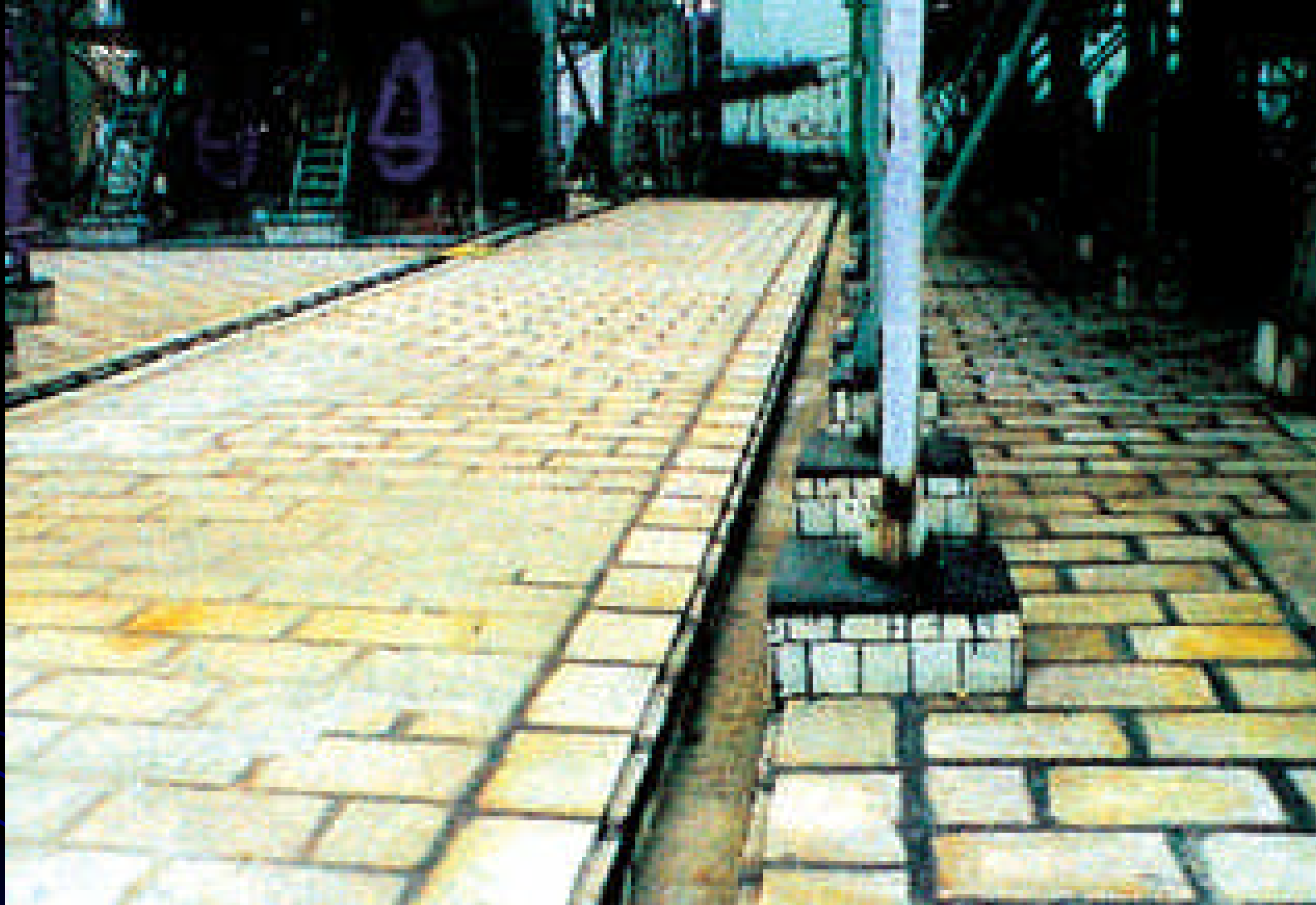
湘潭电化集团有限公司 电解二氧化锰车间地面、水沟防腐施工现场
